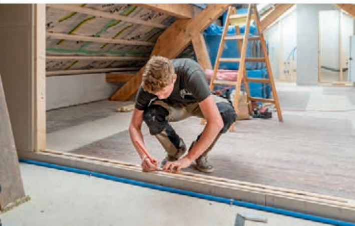
^ Vermessen Holzbauerelemente müssen genau passen, dicht sein und tragende Funktionen erfüllen. Das gelingt nur, wenn die Berufsleute die Räume genau ausmessen.
