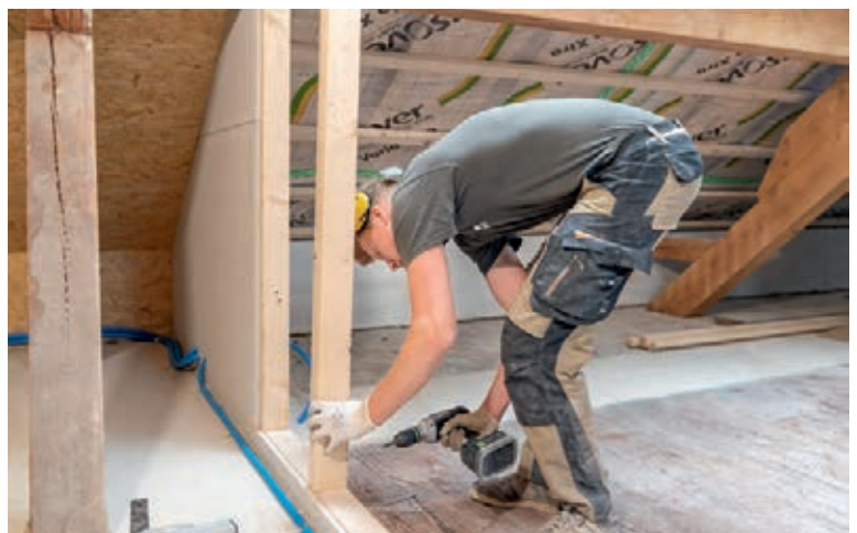
^ Innenausbau Die Berufsleute haben nicht nur auf Dächern zu tun, sondern arbeiten auch in Innenräumen und ziehen zum Beispiel Zwischenwände ein.
