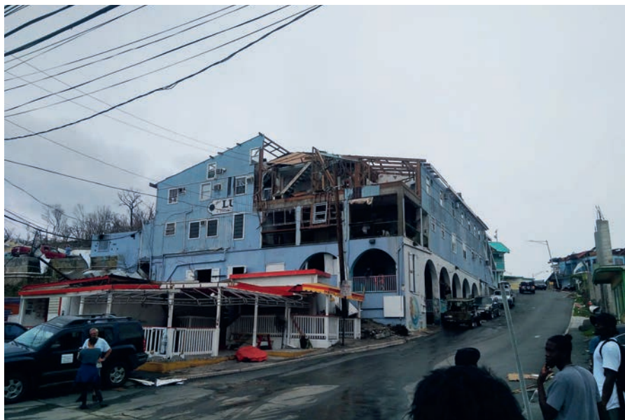
Sturmschäden in der Karibik – die Ärmsten trifft es am schwersten.
